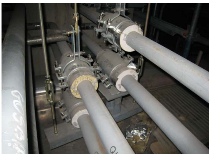
Tuberías sujetas en posición mediante soportes criogénicos
