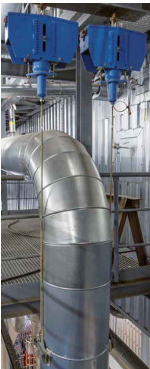
Soporte colgante de carga constante en una central eléctrica de carbón
